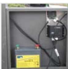
Boîtier de stockage des batteries
