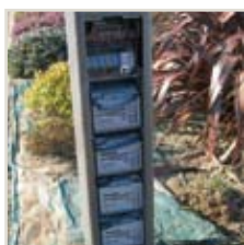
Batteries sur rack intégrées
